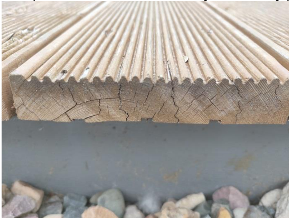
Рис. 7. Пороки исследуемых террасных досок (торцевые трещины)
